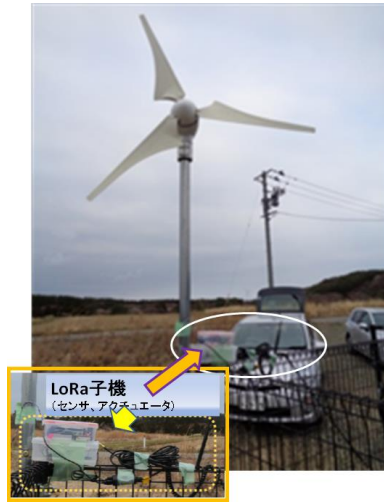
図2 西津軽郡深浦町の小型風車敷地（多摩川ホールディング社管理）設置の超小型風車支柱に付設した環境監視・振動センサデバイス（2020.3.26）
