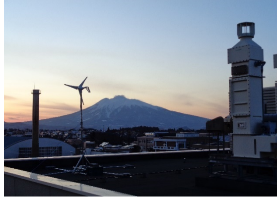
図3 弘前大理工学部 屋上に設置の2機目の分散型超小型風車写真（2020.3.25）
