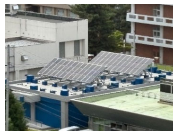
屋上太陽光パネル
