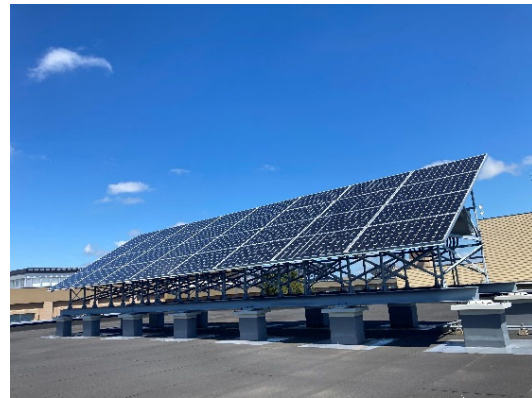
(文京町) 大学会館 太陽光発電設備
